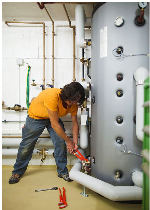
Dichtheitskontrolle am Speicher
