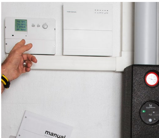
Surveillance à distance
