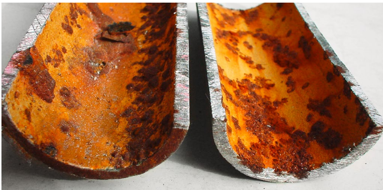
Corrosion dans un tuyau de chauffage
