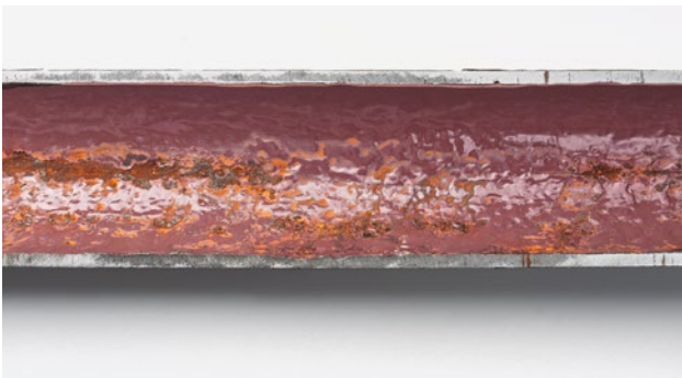
Abb. 2: Mangelhafte Reinigung und Beschichtung des Rohres (Quelle: SVGW)
