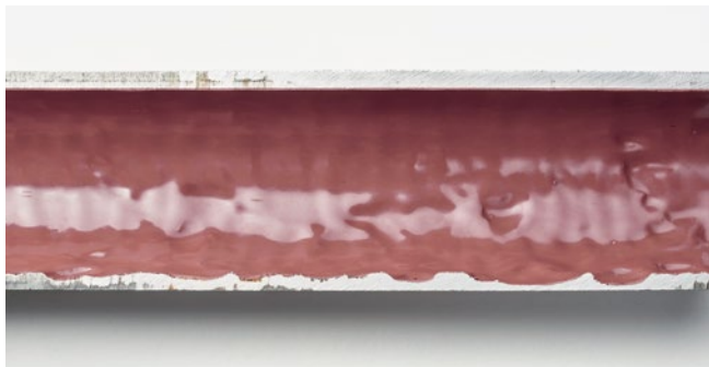
[ABB. 2] Durch Korrosion geschwächte Wandstärke.
