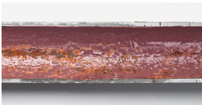
[ABB. 3] Mangelhafte Reinigung und Beschichtung des Rohres.
