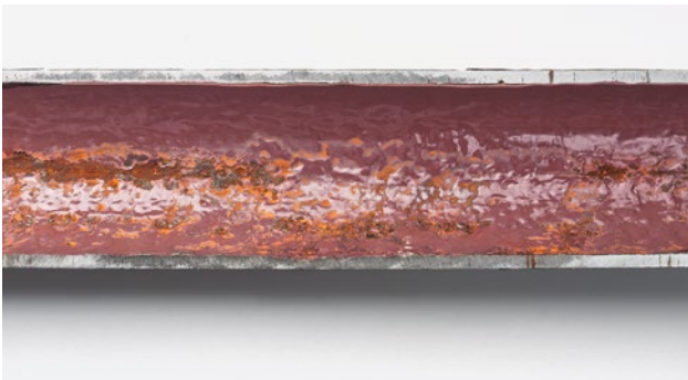
Photo 2 : nettoyage et recouvrement insuffisants du tuyau (source : SSI GE)
