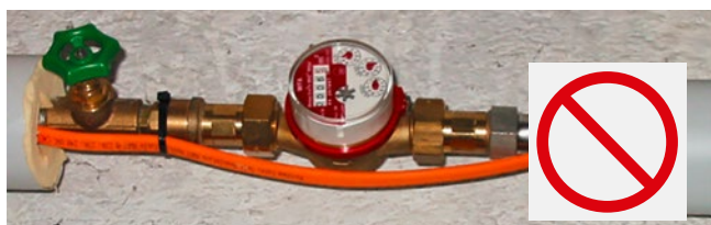
[FIG. 3] Le ruban autorégulant devrait être installé au-dessous du tuyau et isolé.
