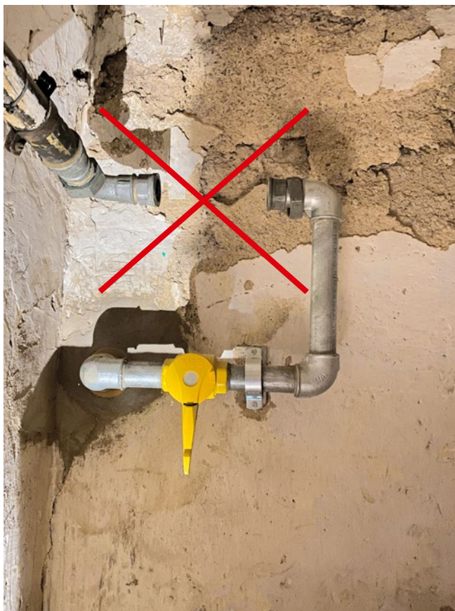
[FIG. 1] Démontage effectué de manière incorrecte : il manque des bouchons.
