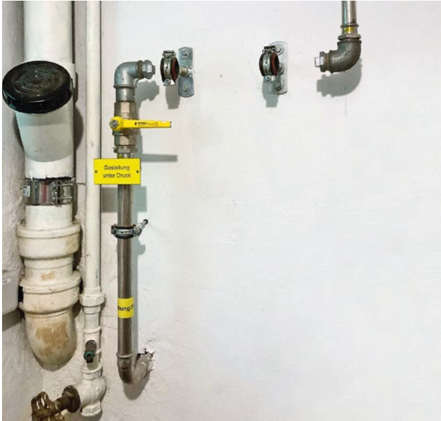
[FIG. 4] Démontage effectué de manière correcte.
