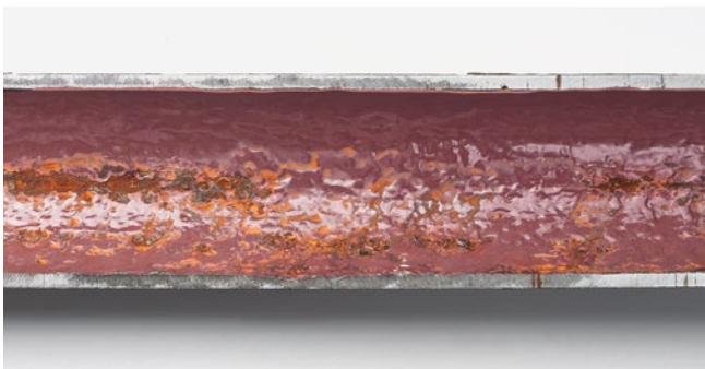
[FIG. 3] Pulizia e rivestimento difettosi della condotta.
