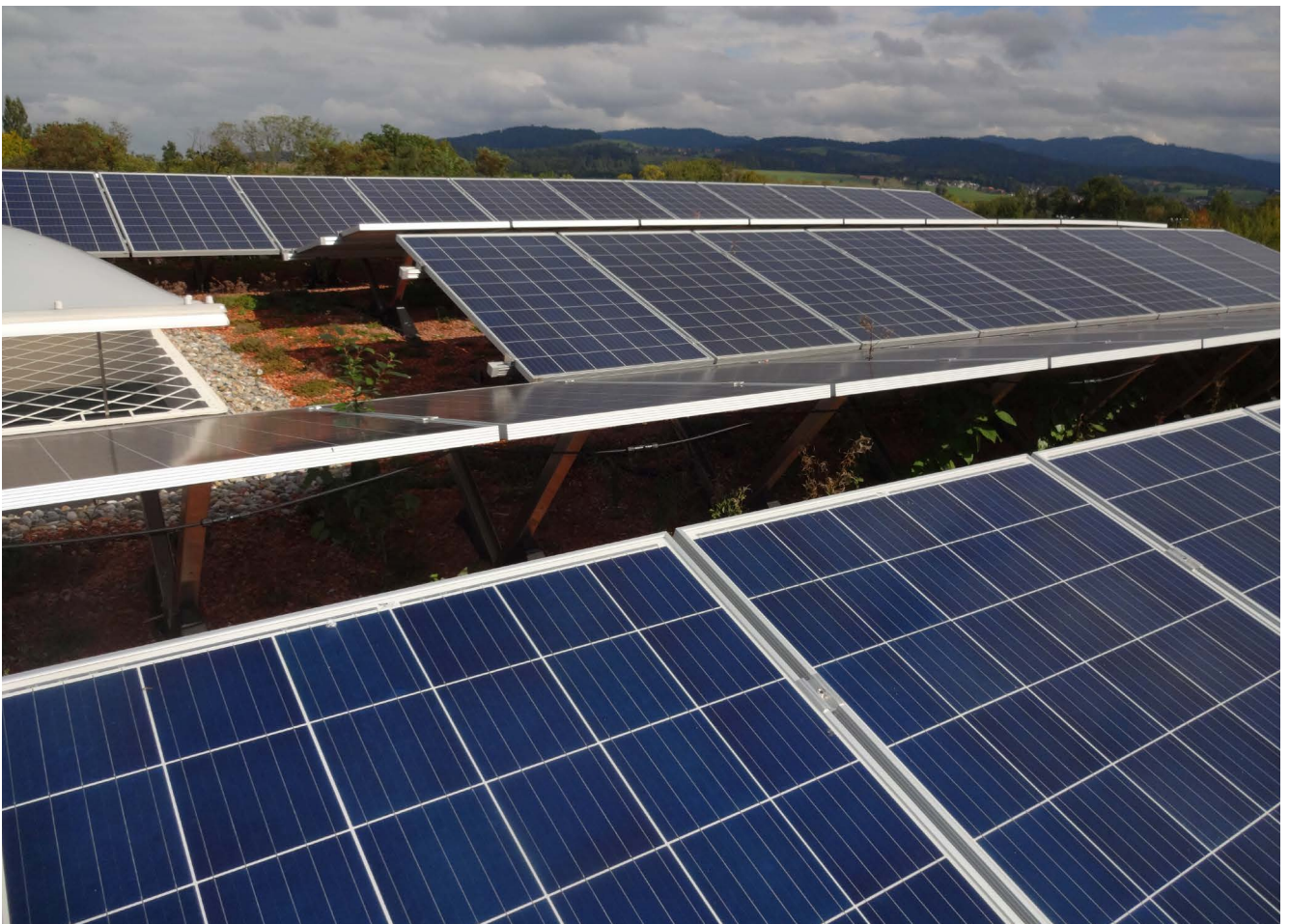
Figure 14: Installation photovoltaïque orientée à l'est/ouest avec une structure de substrat modelée de hauteur différente, source: Contec
