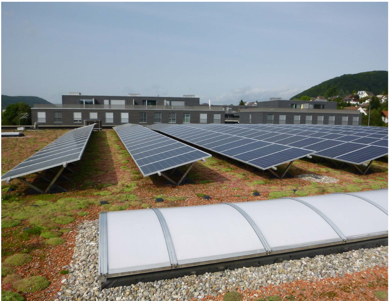
Figure 11: Installation PV orientée au sud avec une structure de substrat minimale, source: Contec
