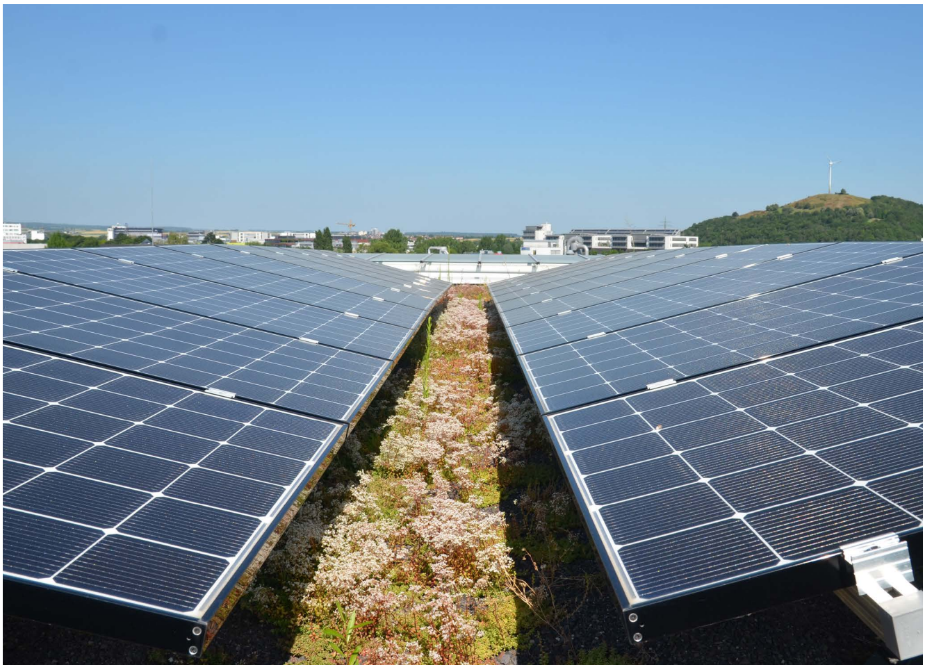
Figure 13: Installation PV orientée à l'est/ouest avec une structure de substrat minimale, source: Bauder
