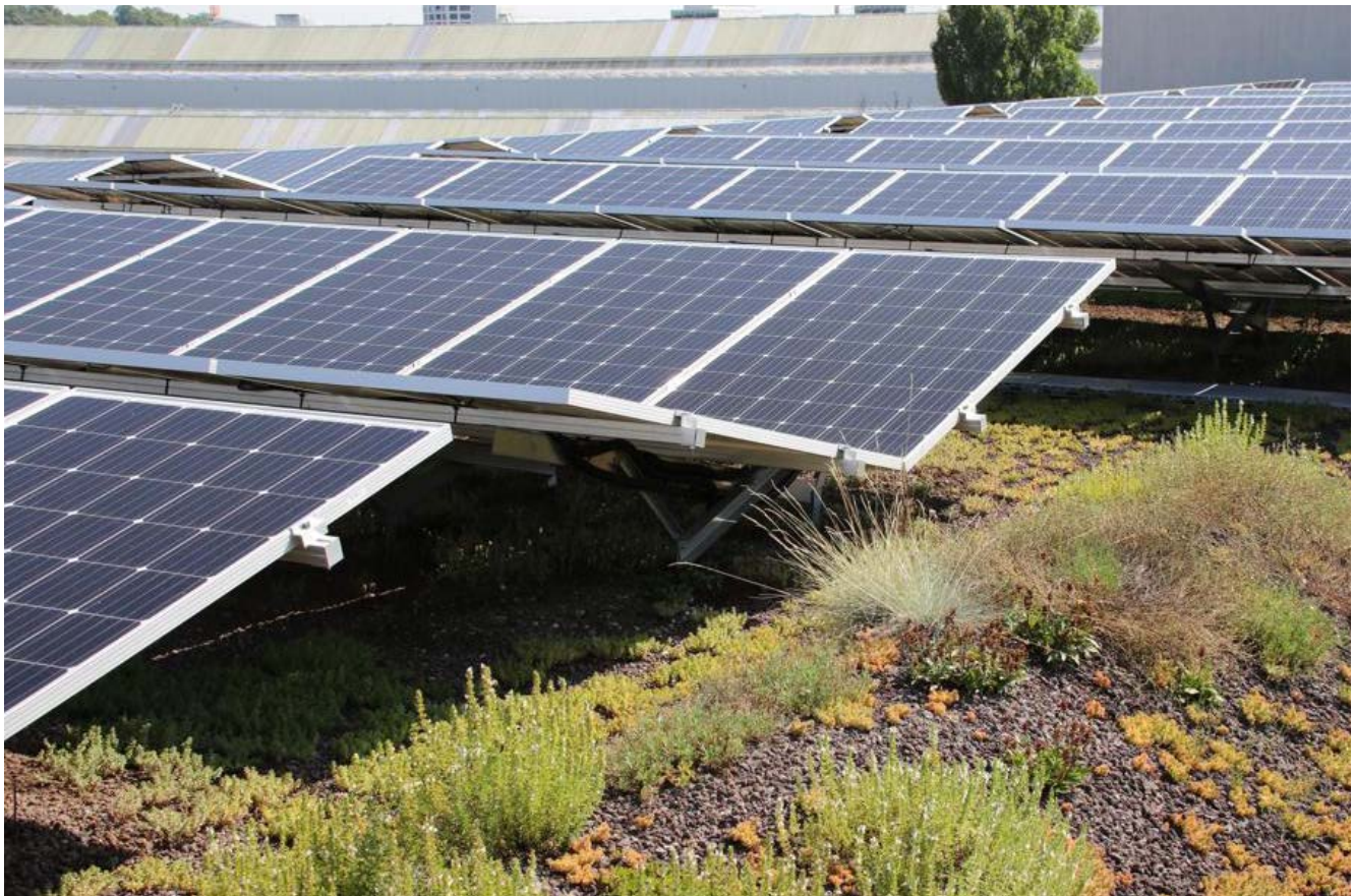
Figure 15: Installation PV orientée à l'est/ouest avec une structure de substrat minimale, source: Zinco
