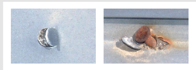
Immagine 3: Perforazioni nella copertura metallica dovute a teste sporgenti dei chiodi.
