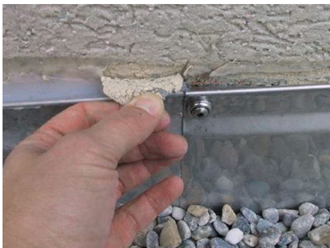
[FIG. 12] Esempio di giunto non eseguito correttamente.
