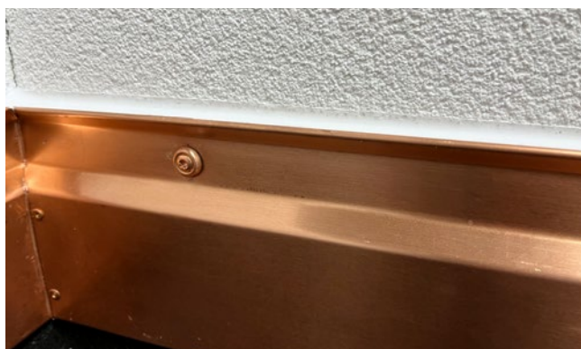
[FIG. 10] Il nastro di mascheratura viene rimosso e le parti in lamiera vengono ripulite da eventuali residui di sigillante o prodotto lisciante.
