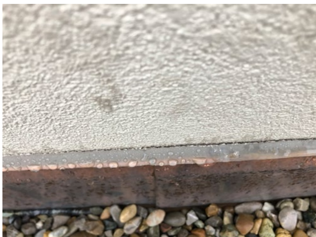
[FIG. 13] Giunto sigillato che con il passare degli anni si è staccato. È necessario intervenire urgentemente per ripristinarlo.
