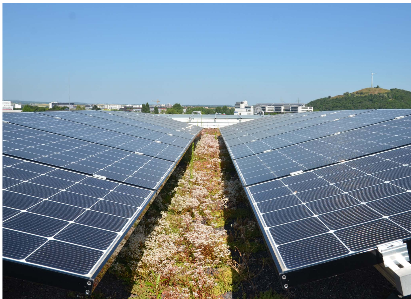
Figura 13: impianto fotovoltaico orientato a est/ovest con substrato minimo, fonte: Bauder
