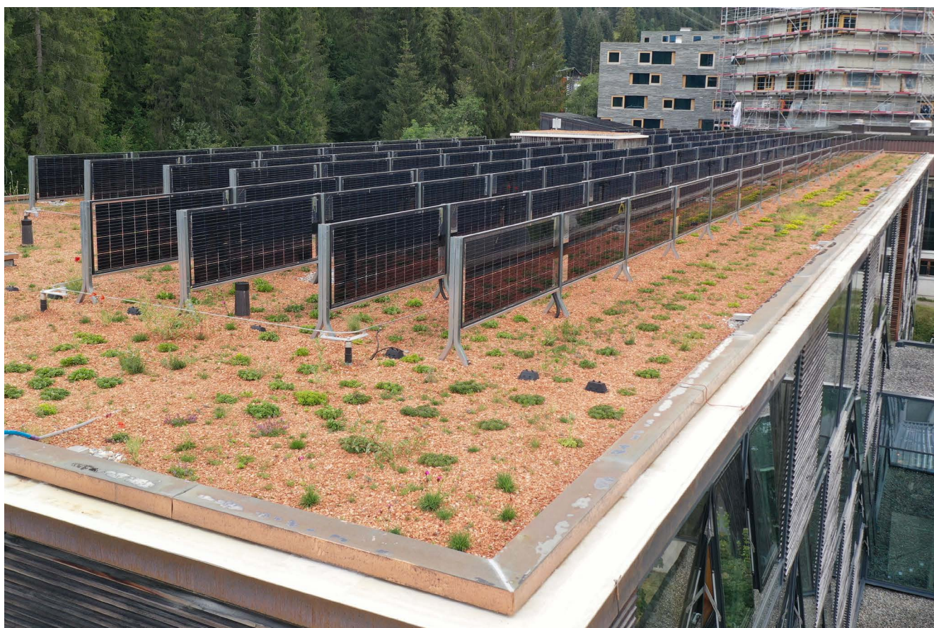
Figura 17: moduli fotovoltaici montati verticalmente con substrato minimo, fonte: Zinco
