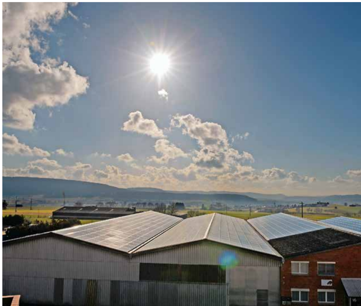
Sonnenkollektoren auf Hausdächern in Löhnigen – von den 143 im letzten Jahr neu installierten Fotovoltaikanlagen im Kanton waren 41 Sun-Control-Anlagen der Elektrizitätswerk des Kantons Schaffhausen (EKS) AG.
